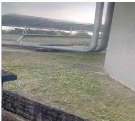
Corte césped planta agua potable
